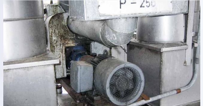
Allweiliger Tankentleerungspumpe im Einsatz
